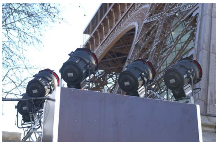
Luminaires were placed at locations around the base of the tower to illuminate the lower half. Other units were located within the structure itself to light the upper half. -Les projecteurs sont placés par groupe de 5 autour de chaque pilier afin d'illuminer la partie basse, les autres projecteurs sont situés dans la structure
